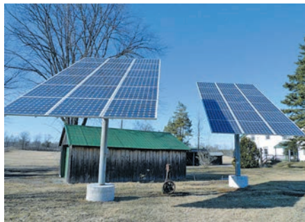
Рис. 9. Напівпровідникові сонячні панелі, встановлені на приватній ділянці
